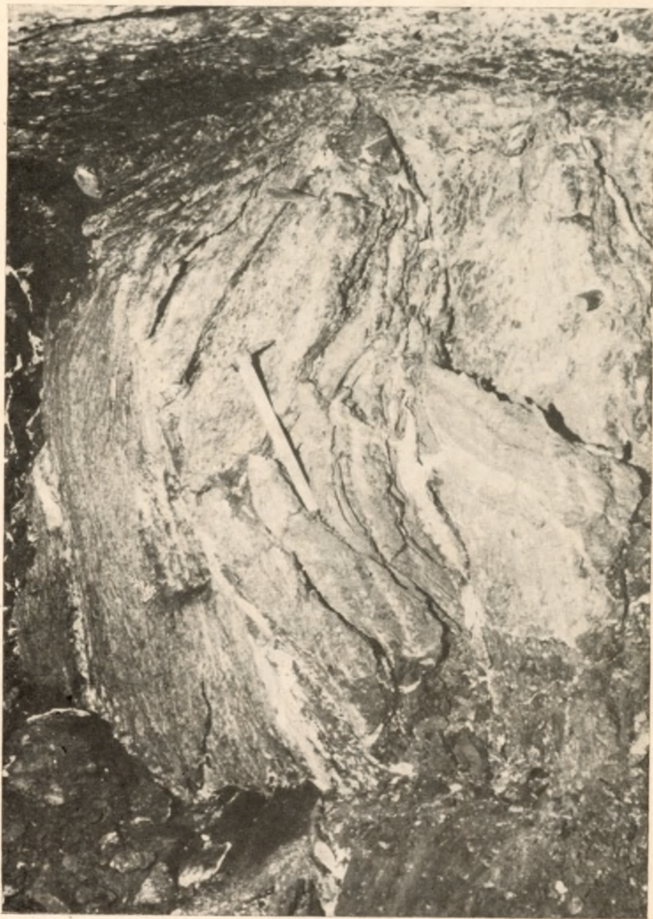
Fot. 4. Deformacje ściany w zespole komór „Bąkle”
