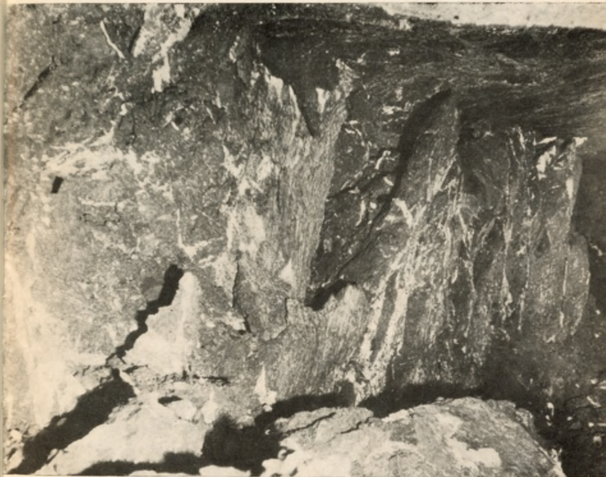
Fot. 5. Odspojenia i spękania ściany w zespole komór „Bąkle”
