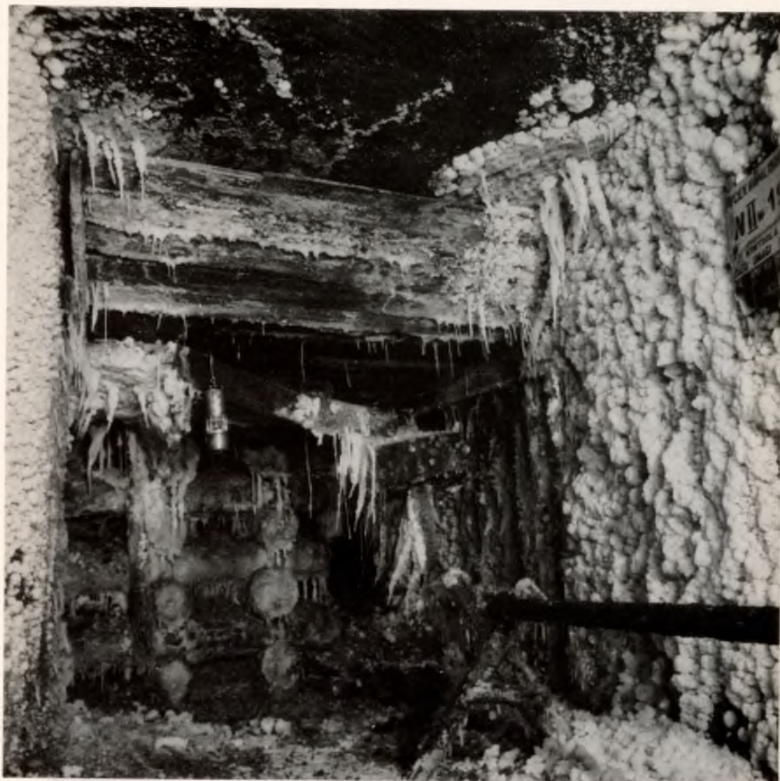
Fot. 5. Komora „Ferro Górna” — wyciek „W IIw-19”
