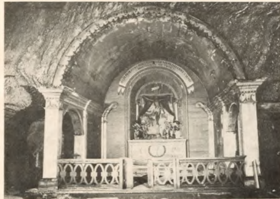
Fot. 5. Kaplica Sw. Jana w komorze „Lipowiec”, poziom I. Widoczne zacieki wilgoci na sklepieniu
