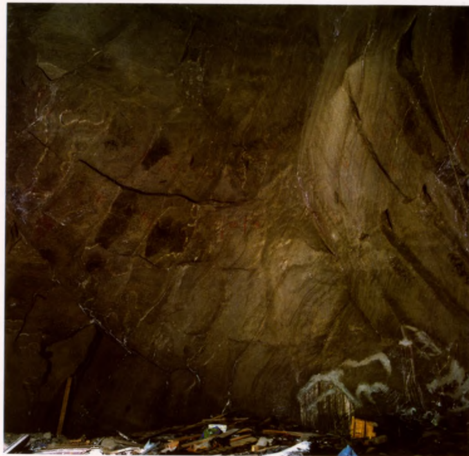
Fot. 1. Komora Haluszka III eksploatowana wrębówką Demag ze śladami uszkodzeń w ociosie południowym
