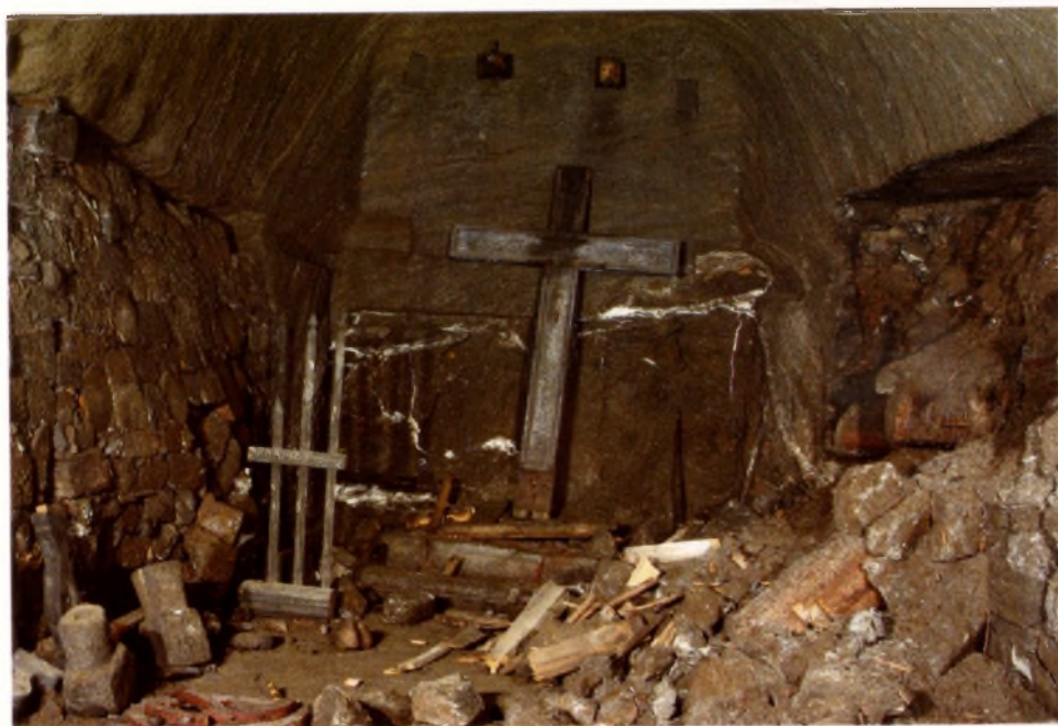
Fot. 2. Kaplica Św. Krzyża (tzw. Pistla) w komorze Piżmowa na poziomie I – widok ogólny; we wschodniej części nastąpił obwał ściany wykonanej z muru solnego
