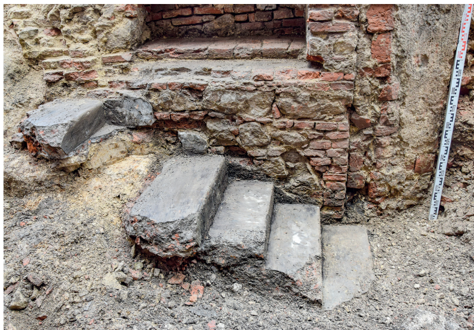
11 i 12. Wypreparowana ceglana konstrukcja
